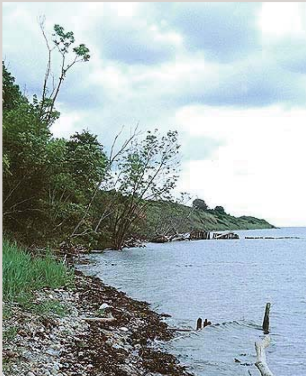
Kystklinten ved Albæk Hoved fotograferet ved højvande i sommeren 2003. Klinten var på dette tidspunkt stærkt tilskredet. Overalt er det forsøgt at kystsikre, dog uden stor effekt. Klinten indeholder nogle særdeles skredvillige lag.
