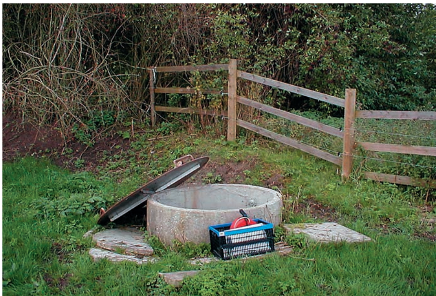
Fritliggende boring beskyttet af brøndring af cement og ståldæksel. Boringen anvendes til forsyning af en enkelt husstand (Foto: Rovesta Miljø)
