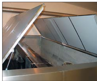
Et kig ned i et sandfilter på et vandværk.
